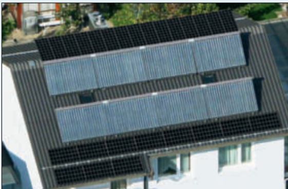
Bild Fotovoltaikanlage von Kyocera am Dach von Ökohaus-Althaus
