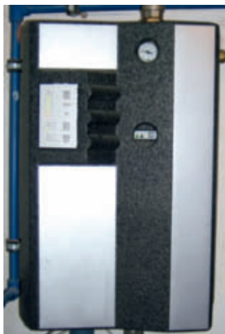
Der Regenwasser-Manager stellt bei Bedarf Wasser zur Verfügung.
