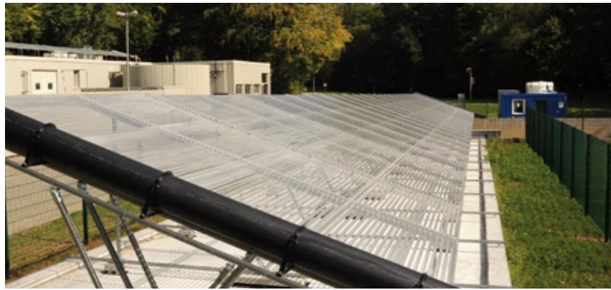
Demonstrationsanlage Lampoldshausen: Hier reinigt der RayWOx Raketenabwässer.
