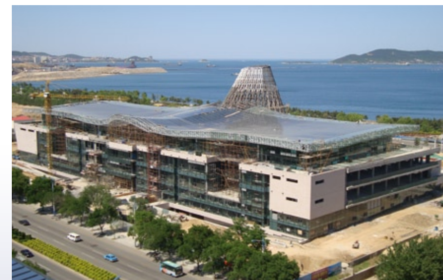
Eine PV-Anlage krönt das Kulturzentrum in Weihai.
