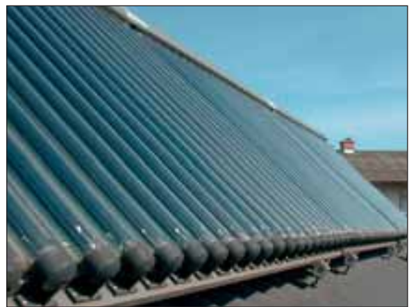
Bild: SOLution VAKUSOL am Dach von Ökohaus-Althaus.
