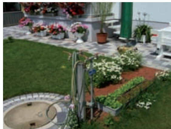
Regenwasserzisterne mit Regenwasserzapfstelle
