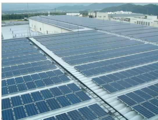
Solarmodule auf dem Dach (Standort: Shiga Yohkaichi)
